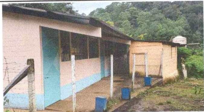
Foto1: Vista externa del modulo de aulas a remozar, se puede observar la situacion actual modulos.
