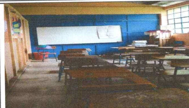
Foto 2: Vista interna del modulo de las aulas, se puede observar la situacion actual del y piso dentro de las cuales se instalará piso porcelanato.
